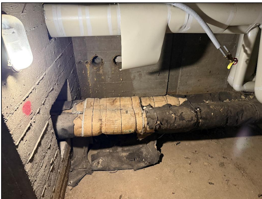
Bild 2: Leitungskeller, Restbestände Heizleitungen mit Mineralwolle „Kamilit“ oder Glaswolle
