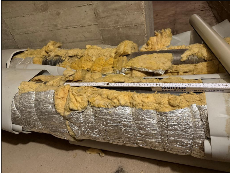
Bild 3: Leitungskeller, Heizleitungen mit Glaswolle „Isover“, krebserzeugender Gefahrstoff
