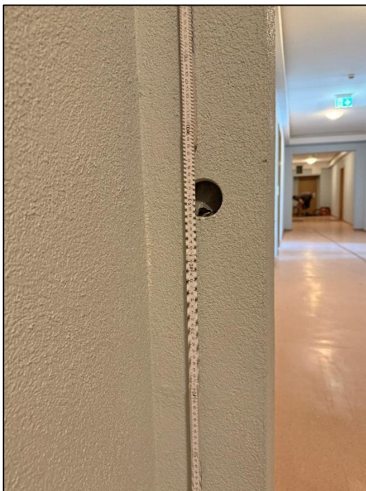
Bild 6: Schachtverkleidung Hausflur mit Gipskartonverkleidung
